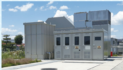
設置された非常用発電設備
